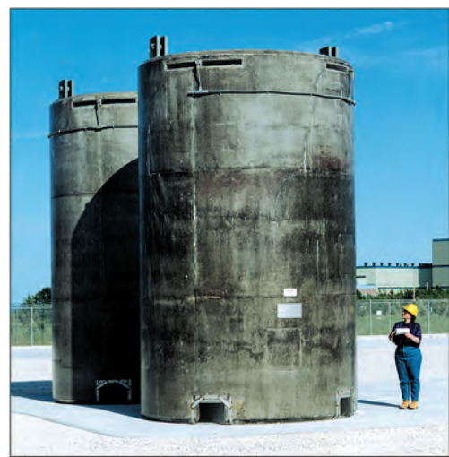
Trockenlagerung von abgebrannten Brennelementen.
